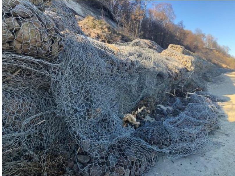
Рисунок 1.16 – Участок 4 – Частично разрушенные габионы со следами волнового заплеска
