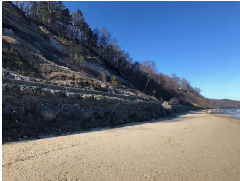
Рисунок 1.15– Участок 4 – Частично разрушенные габионы
