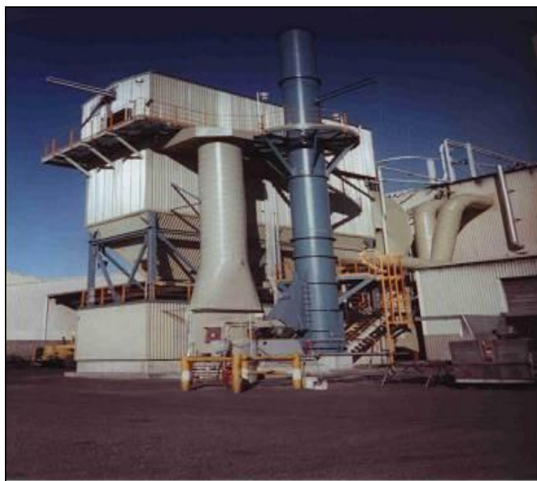
Рисунок 6.2.1.1-4. Установка регенеративного термического окисления (РТО)
